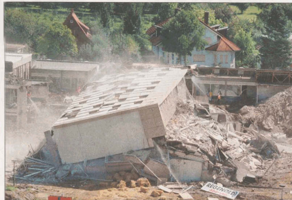
Wie ein Kartenhaus liegt der einstige Stahlbeton-Koloss am Boden.
