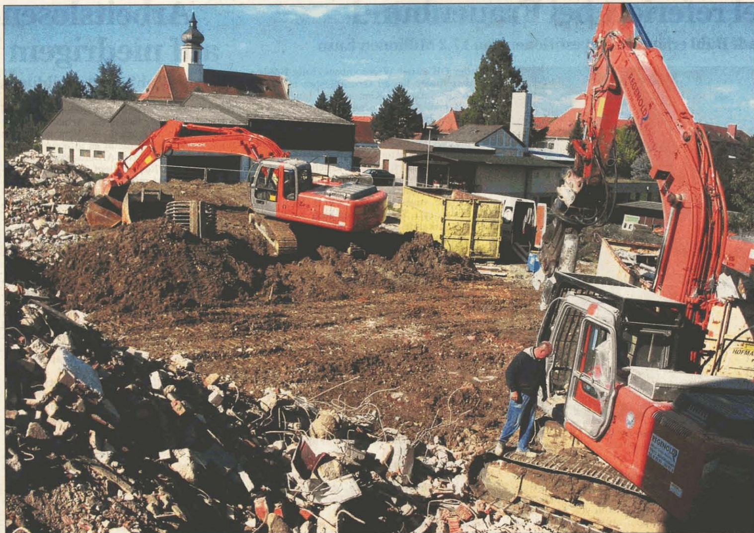
PLATZ FÜR WOHNBEBAUUNG: Bereits am Werk sind die Bagger, um das Gebäude der ehemaligen St.-Hedwig-Schule am Bühler Sonnhaldeweg abzubauen. Morgen gegen 14 Uhr erfolgt die Sprengung des Hochhauses. Foto: Roland Huck
